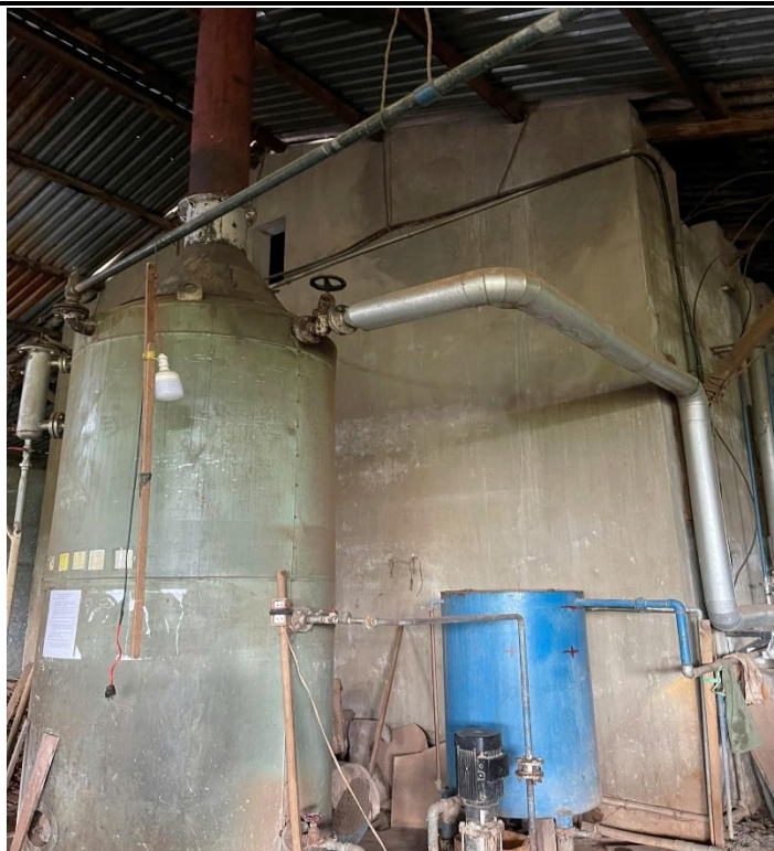
Hình 11. Hình ảnh lò hơi tại Nhà máy
